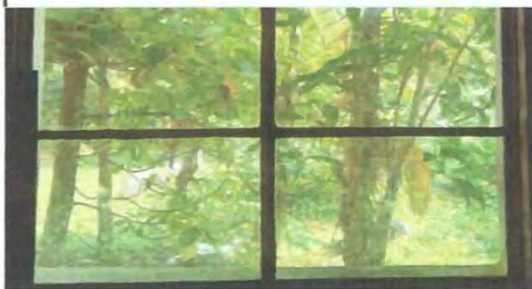
Foto 3: VENTANAS DE LA COCINA QUE NO CONTIENEN ENTRADA DE AIRE, NECESITAN SER SUSTITUIDAS POR UNAS QUE TENGAN LA VENTILACIÓN ADECUADA.
