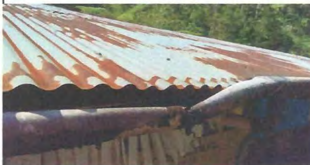
Foto 4: CANALES DETERIORADOS QUE NECESITAN SER SUSTITUIDOS POR CANALES DE ALTO CAUDAL.
