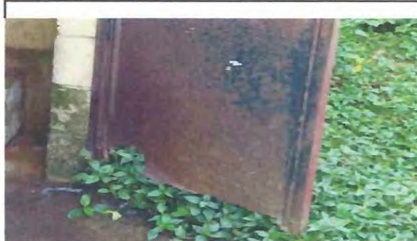
Foto 2: PUERTAS EN MAL ESTADO POR DETERIORO NESECITAN SER CAMBIADAS Y CAMBIO DE CHAPAS DE PUERTAS DE LOS AMBIENTES DE LA ESCUELA.
