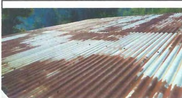
Foto1: LÁMINAS DETERIORADAS DEL TECHO Y NECESITAN SER SUSTITUIDAS POR LÁMINAS TROQUELADAS.
